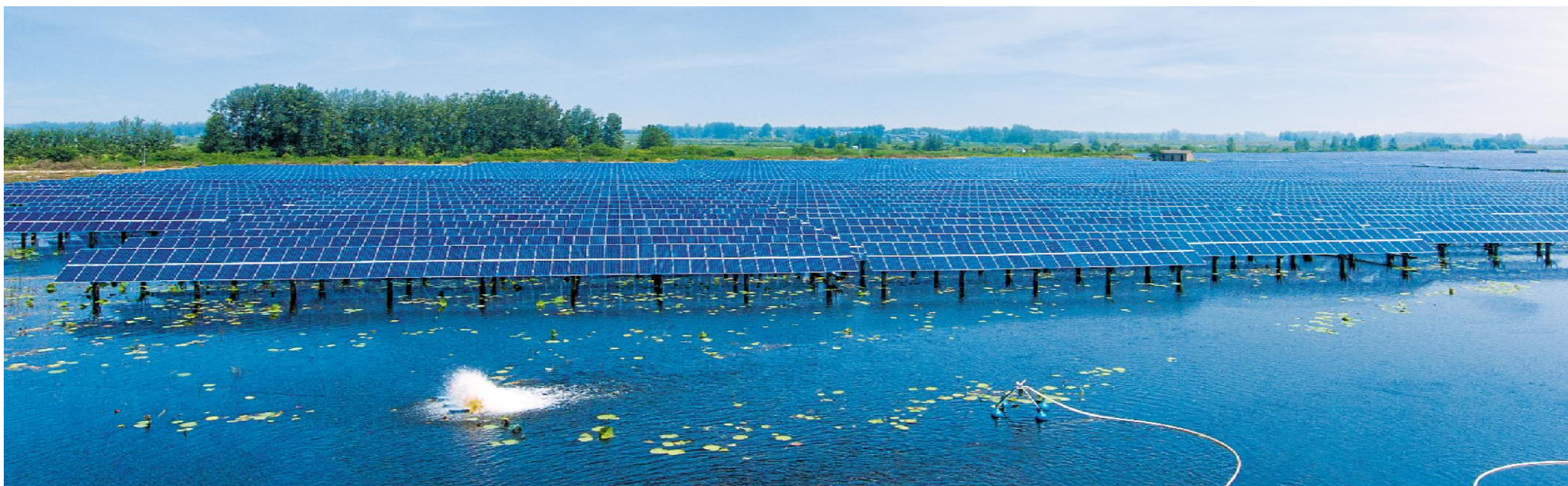
通威和县“渔光一体”基地
